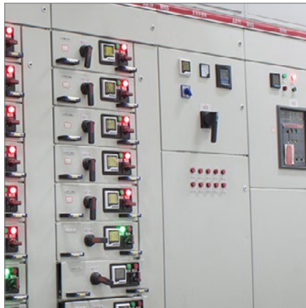
Die schlüsselfertigen Lösungen umfassen auch die Planung und Herstellung der Schaltschränke
